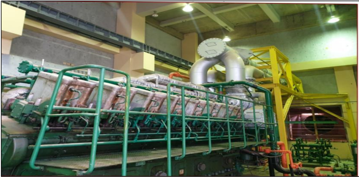
Figure I.9: générateur de secours phase 2.
