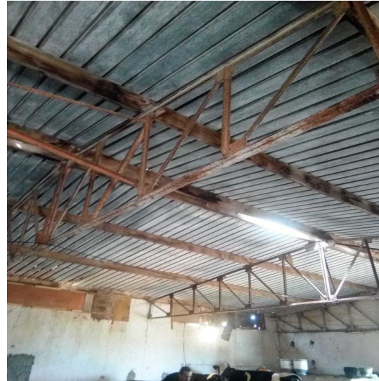
Figure 46 : Toit en tôles et ouvertures colmatées
