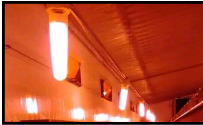
Figure 15: Éclairage du bâtiment d'élevage (Photo réelle).
