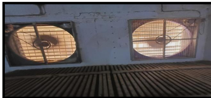
Figure 7: Extracteurs d'air du bâtiment d'élevage (Photo réelle).
