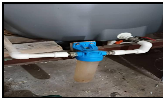
Figure 11: Filtre à eau du bâtiment d'élevage (Photo réelle).
