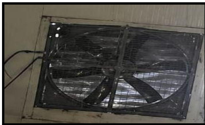
Figure 14: Extracteur d'air pour la ventilation du bâtiment (Photo réelle).
