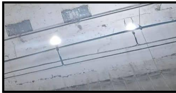
Figure 8: Éclairage du bâtiment d'élevage (Photo réelle),
