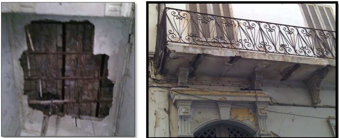
Figure 91 / 92 déformation et l'effondrement partiels des planches
