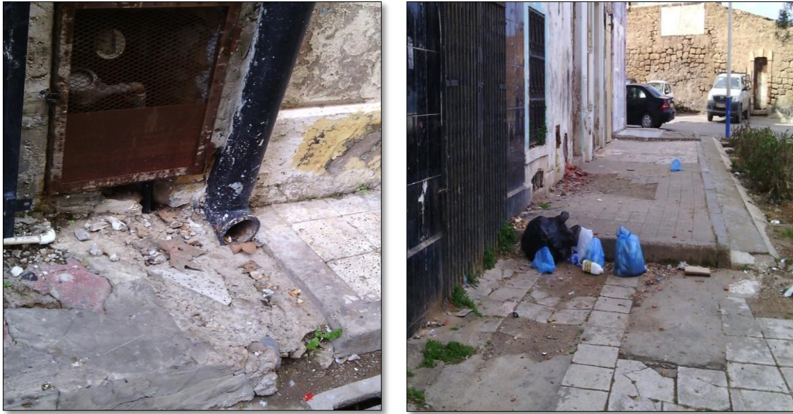
Figure 46 / 47 évacuation des eaux usées sur la chaussée et dépôt sauvage de déchet
