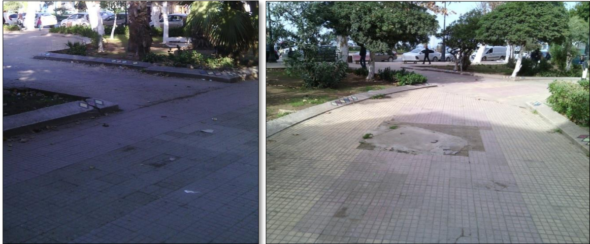
Figure 140 / 145 : Revêtement de la place hétérogène et inapproprié
