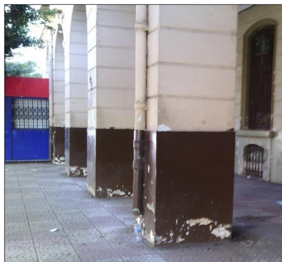
Figure 103 : humidité des enduits des piliers de la banque
