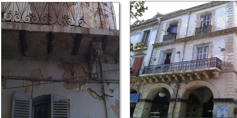
Figure 104 / 105 : corrosion et oxydation des éléments métallique et humidité des enduit de façade
