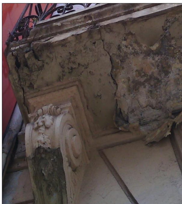
Figure 107 : détachement des consoles de balcon
