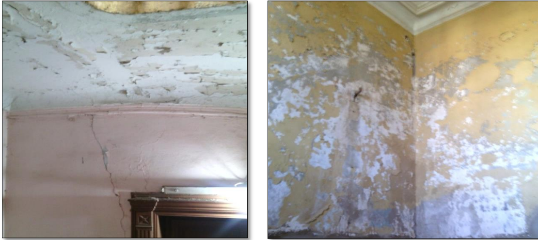
Figure 84 / 85 : dégradation des appartements
