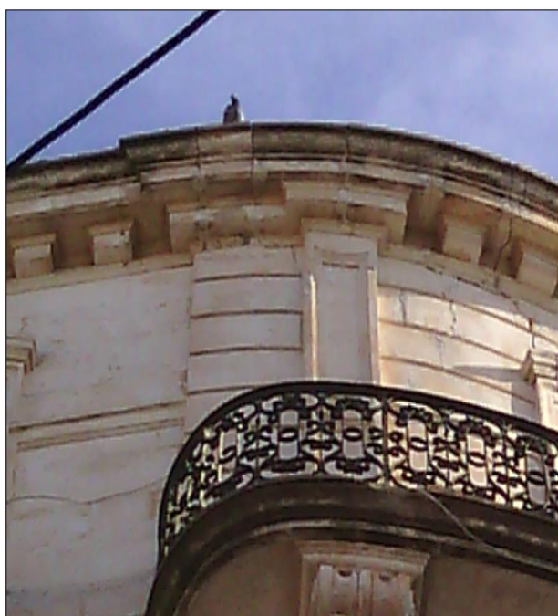
Figure 106 : cassure et perte de mortier de joint dans les corniches de couronnement
