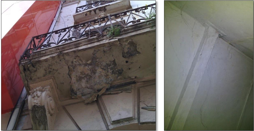
Figure 89 / 90 fissuration des murs et balcons
