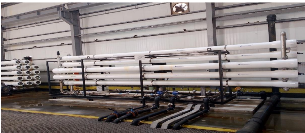
Figure I. 3: Photo de l'unité de dessalement par Osmose Inverse.
