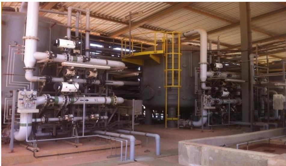
Figure I. 6: Photo de l'unité de déminéralisation
