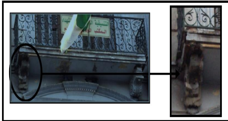
Photo. 2.23 Décollement partiel d'un l'ornement de la façade l'immeuble d'habitation N°3
