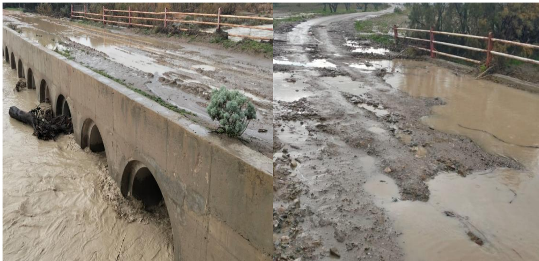
FIGURE. XIII. 2: Dégradation de la chaussée et des talus au niveau du projet étudié
