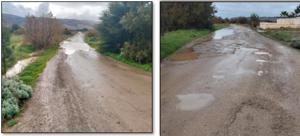
figure.I. 4:État actuel de dégradation du tronçon routier étudié
