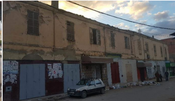
dégradation du bâti
