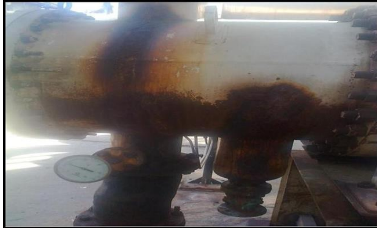
Figure 19: corrosion de la boîte de distribution de l'échangeur E-504
