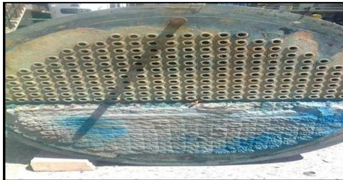
Figure 18: Dépôt de tartre formé sur les faisceaux tubulaires de l'échangeur
