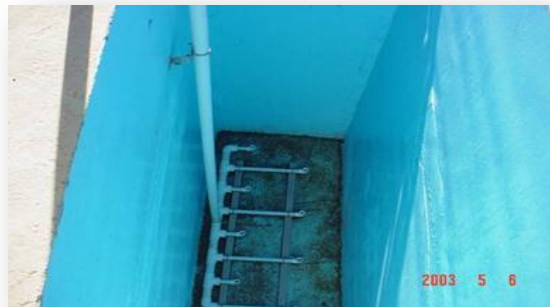
Figure 6 :Bassin de désinfection .
