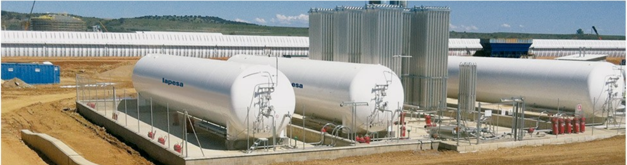
Figure I.8 : réservoirs cryogéniques horizontaux.
