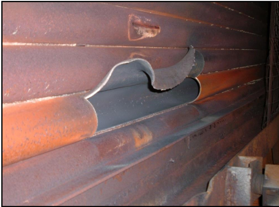
Figure III.11 : Phénomène de fluage causé par corrosion par fatigue (éclatement d'un tube).
