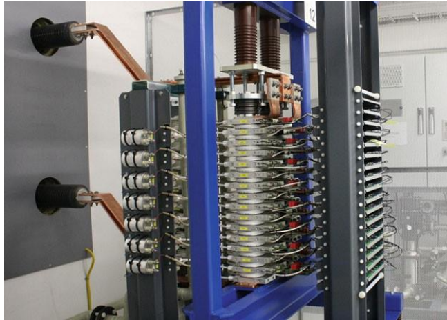
Figure IV.8 thyristor de SVC dans la sous-station de Kangasala en Finlande. [7]
