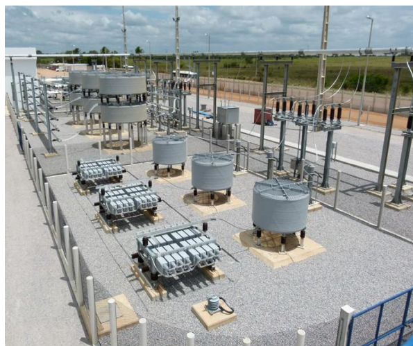
Figure IV.9 Filtres harmoniques installés avec SVC (GE COMPANY).
