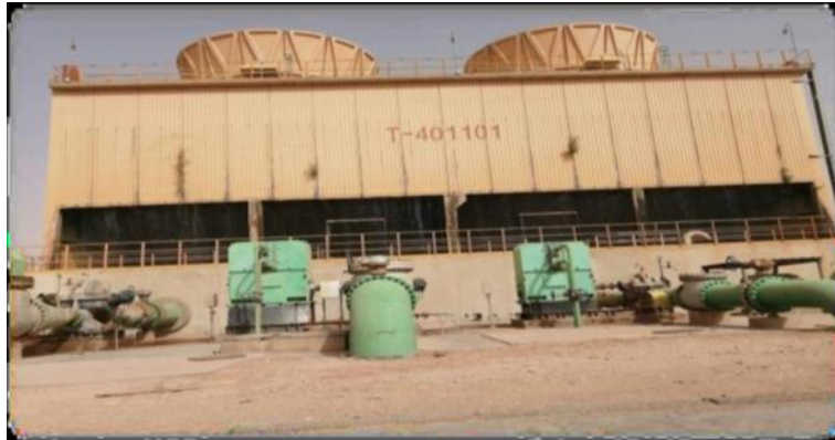
Figure I.7: Tour refroidissement d'eau
