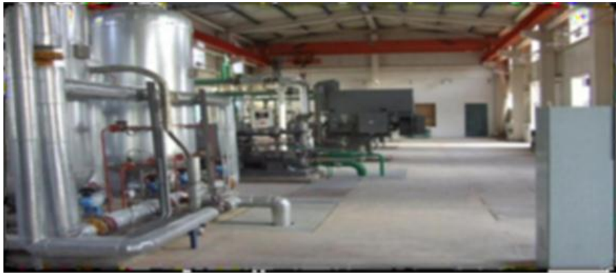
Figure I.6: Unité d'air comprimé
