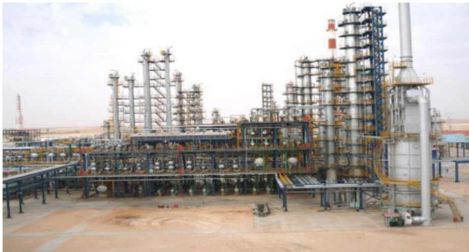
Figure I.3 : Unité distillation atmosphérique
