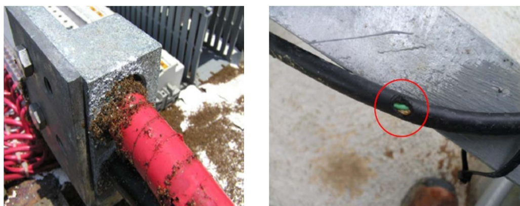
Figure (III.3) : Exemples de défauts rencontrés dans le système de câblage.
