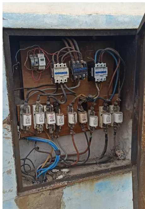
Figure III-4 Armoire sur poste Cité Bellevue
