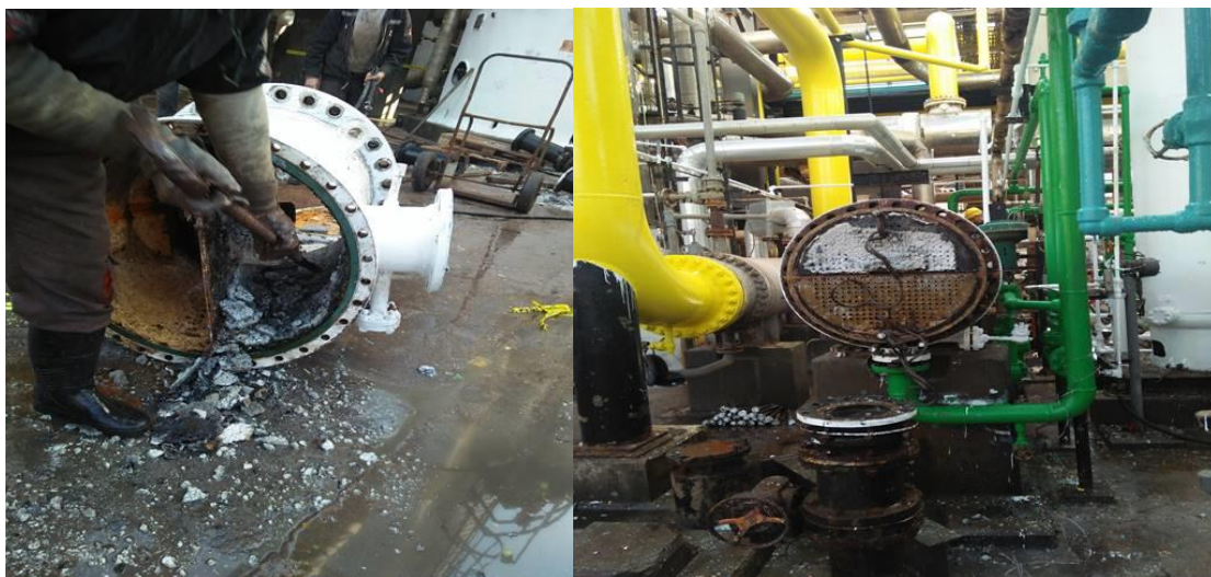
Figure 9 : Bouchage des tubes de l'échangeur E.504
