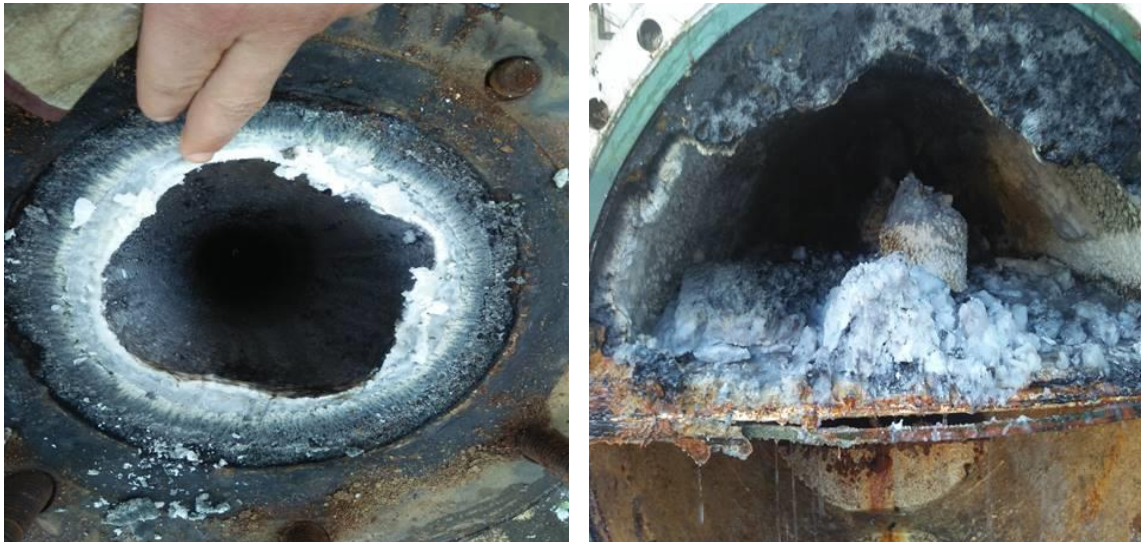
Figure 8 : Les tartes formées sur la boîte de distribution
