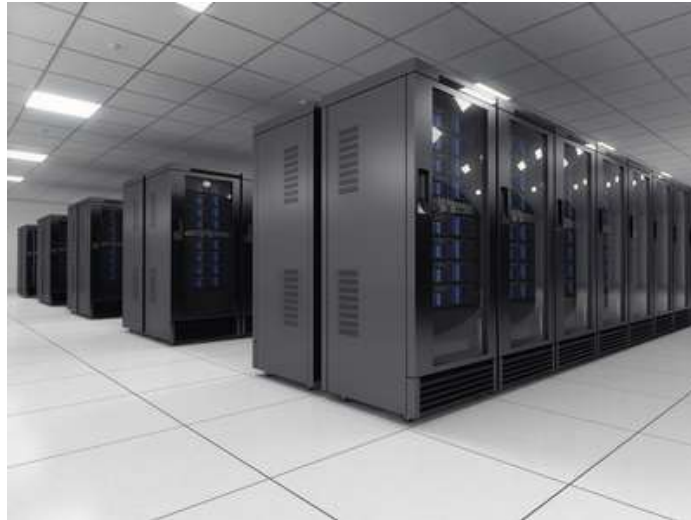
Figure 2. 3 : L'intérieur d'un Data Center
