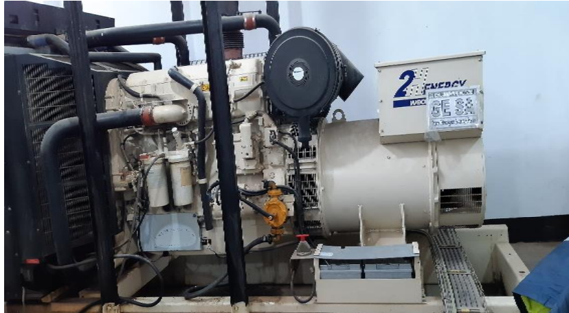
Figure 2-7 :groupe électrogène( source aéroport oran)
