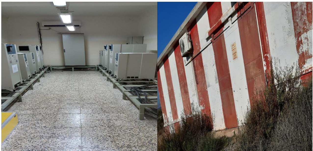
Figure 2-8 : poste électrique (extérieur et intérieur) (source aéroport d'Oran)
