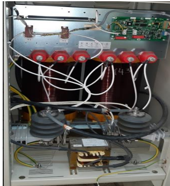
Figure 2-19 : Régulateur à bobine mobile (aéroport d'Oran)
