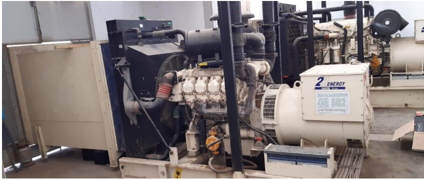
Figure 2-2 : groupe électrogène (source aéroport d'Oran)
