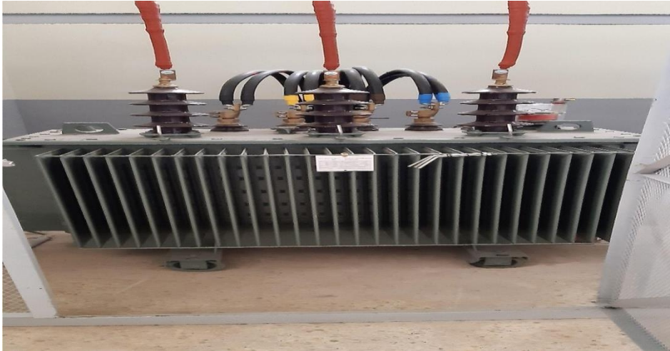
Figure 2-11 : transformateurs (source aéroport d'Oran)
