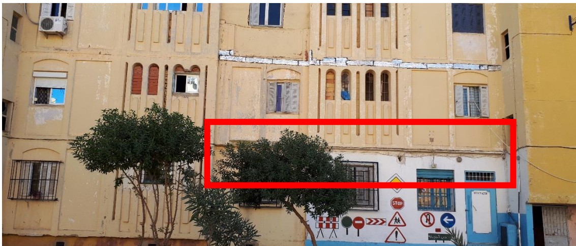
Fig. 112 : Problème d'étanchéité au niveau des parois extérieures, Cas de la ZHUN de cité 5 juillet Mostaganem - Source : Mouaz Sanaa.
