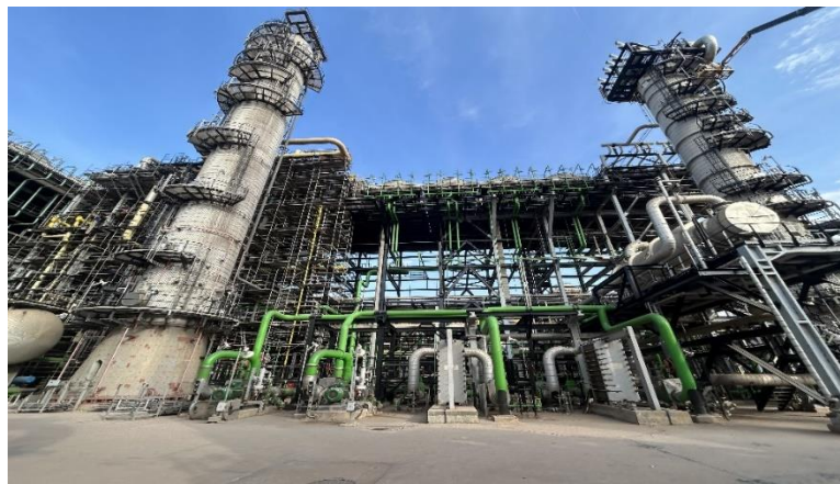
Figure 5: Section de décarbonatation (unité 12).
