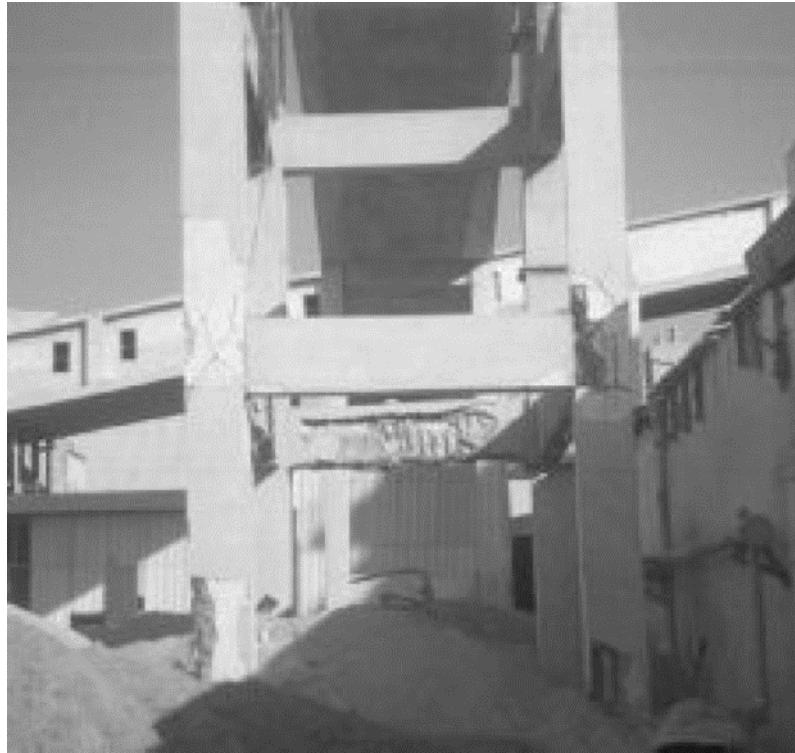
Figure I. 11 : Endommagement des nœuds d'un portique dans une cimenterie lors du séisme Buhj (Inde) en 2001[40].
