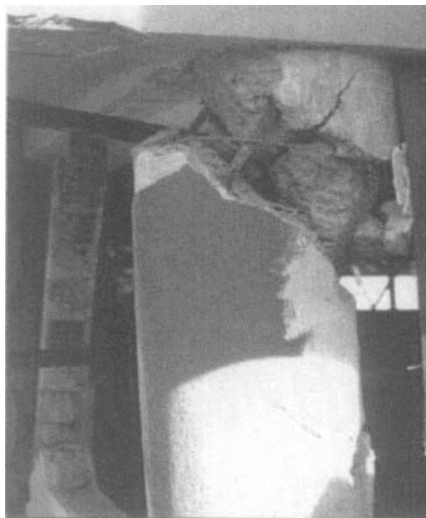
Figure I. 10 : Rupture par cisaillement d'un poteau en béton armé lors de séisme de Kalamata (Grèce) en 1986[40].
