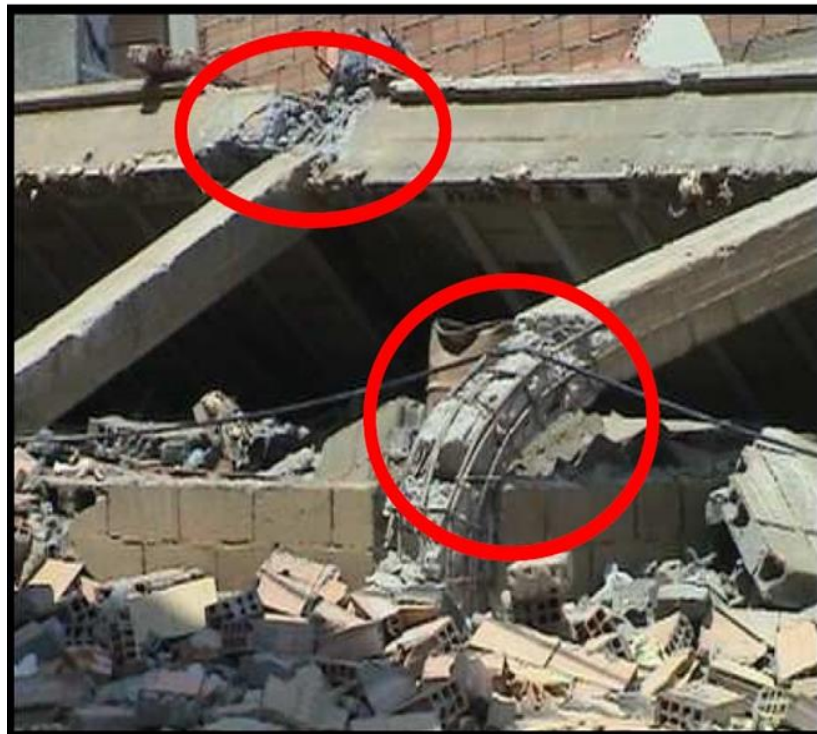
Figure I. 6 : Exemple de dommages d'u bâtiment suite au séisme de Zemmouri 2003[40]
