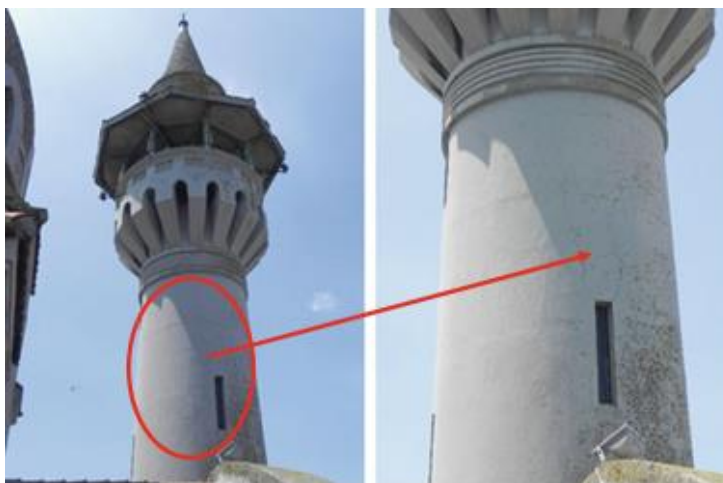
Figure II. 13 : Fissures mineures dans la couche extérieure de revêtement du minaret RC de la mosquée[44].
