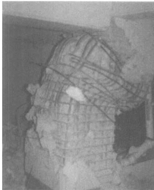
Figure I. 9 : Ruine par flexion-compression d'un poteau en béton armé de 1m de diamètre dans le bâtiment (Motoyama Royal Condominium) lors du séisme de Kobe (Japon) en 1995[40].
