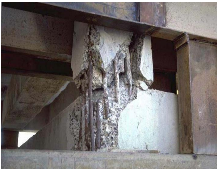
Figure I. 12 : Ruine d'un nœud a la jonction poteau-poutre d'angle lors du séisme de Buhj (Inde) en 2001[40].
