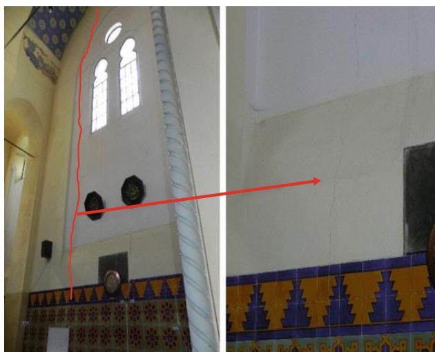
Figure II. 12 : Des fissures verticales se sont développées sur toute la hauteur du mur de maçonnerie[44].
