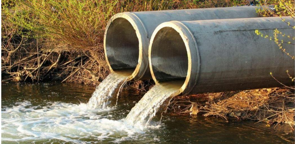
Figure 1. Rejet des eaux usées dans le milieu naturel (MétroQuébec , 2023)
