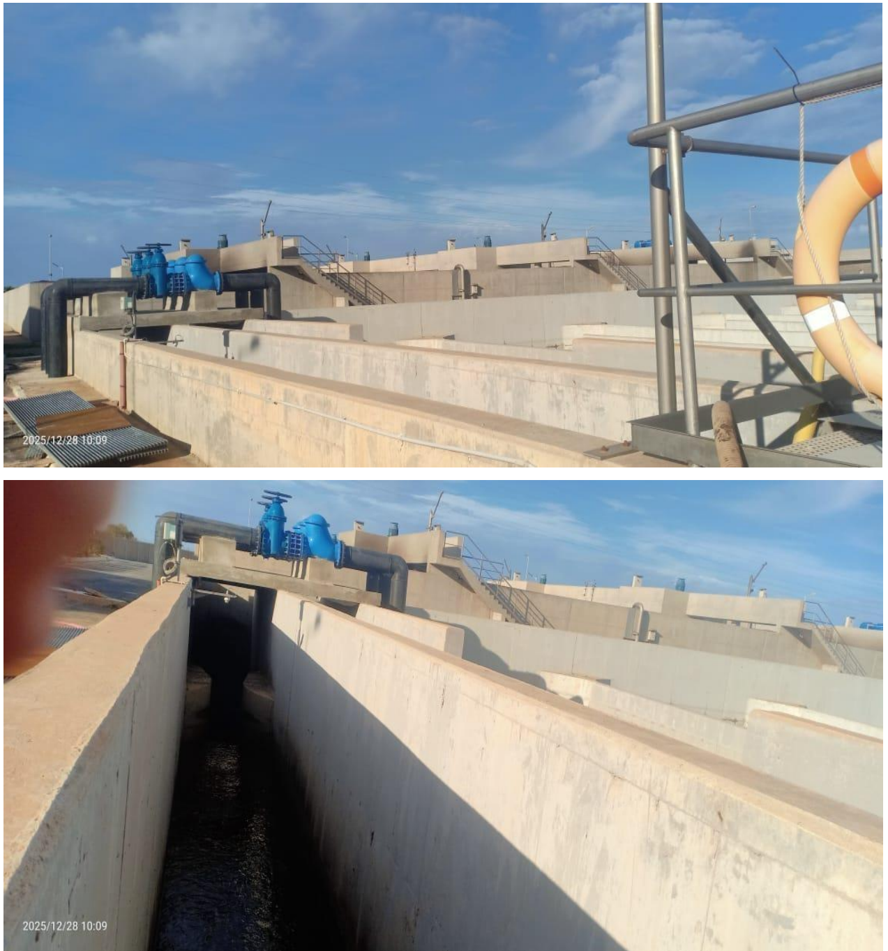
Figure 21. Pompes installées dans des stations de relevage
