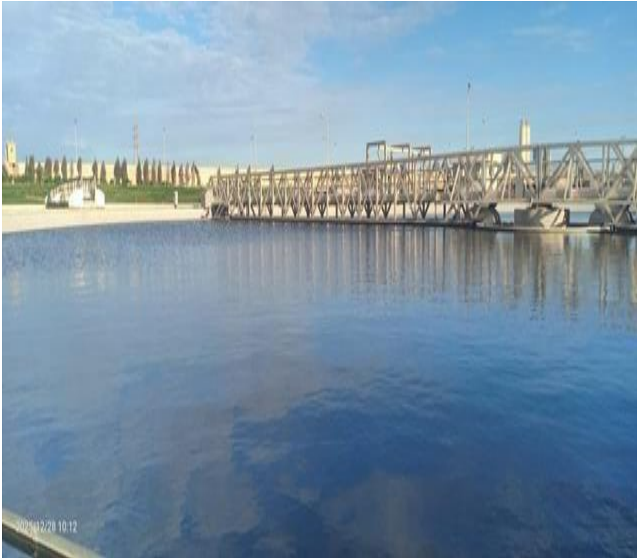
Figure 27. Décanteurs circulaires raclés
