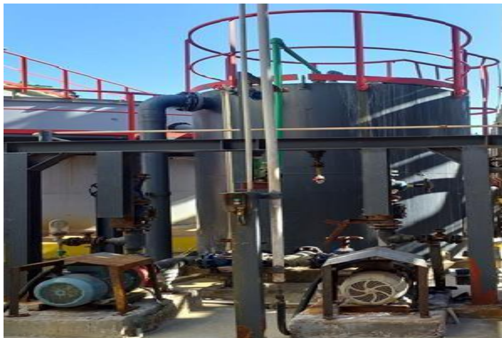
Figure II.11: Bac de stockage T-110 avec deux pompes P-110A et P-110B.
