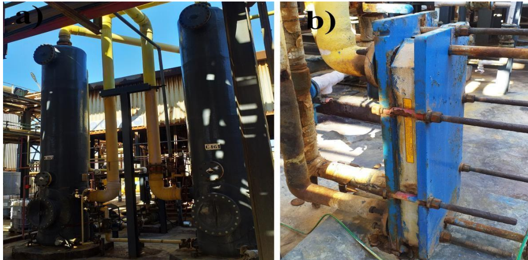
Figure II.21: (a) Sécheur C-161 et C-162 ; (b) Échangeur de chaleur HE-161.
