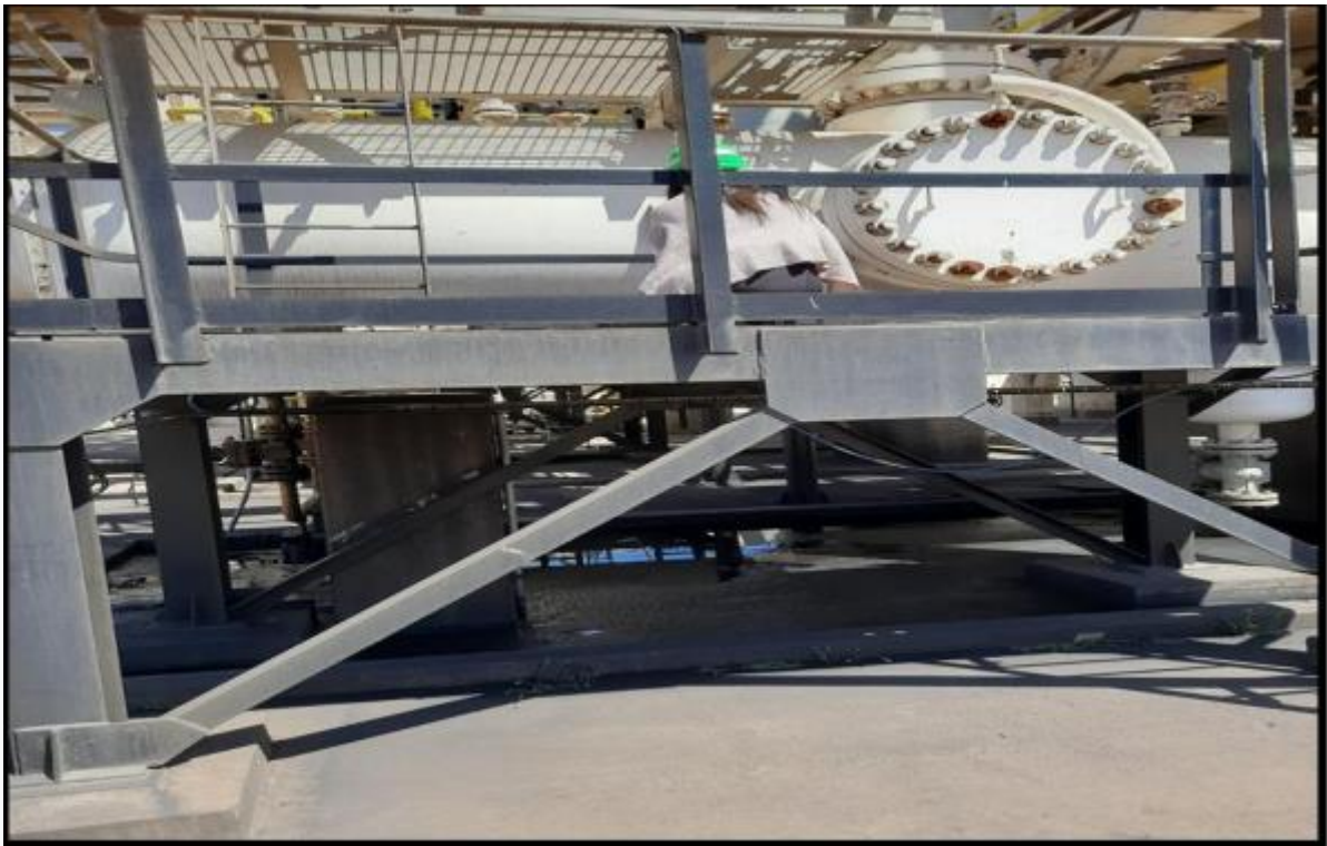
Figure II. 1 : Les filtres de la section de démercurisation (complexe GP1/Z).
