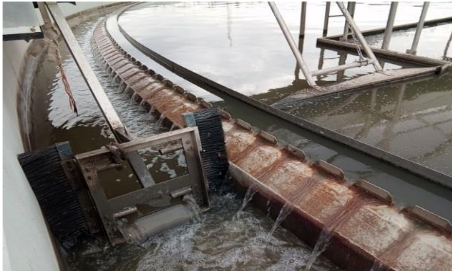
Figure II. 4 : décanteur. (STEP boues activées, Salamandre, Mostaganem)
