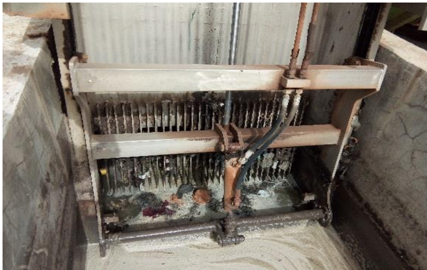
Figure II. 2 : dégrilleur fin mécanique. (STEP lagunage Ami moussa Relizane)
