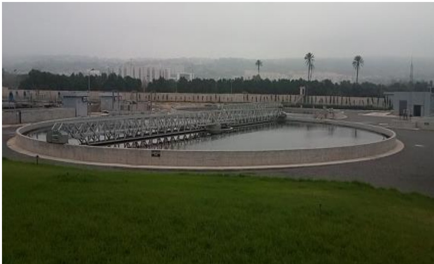
Figure II. 5 : clarificateur. (STEP boues activées, Salamandre, Mostaganem)
