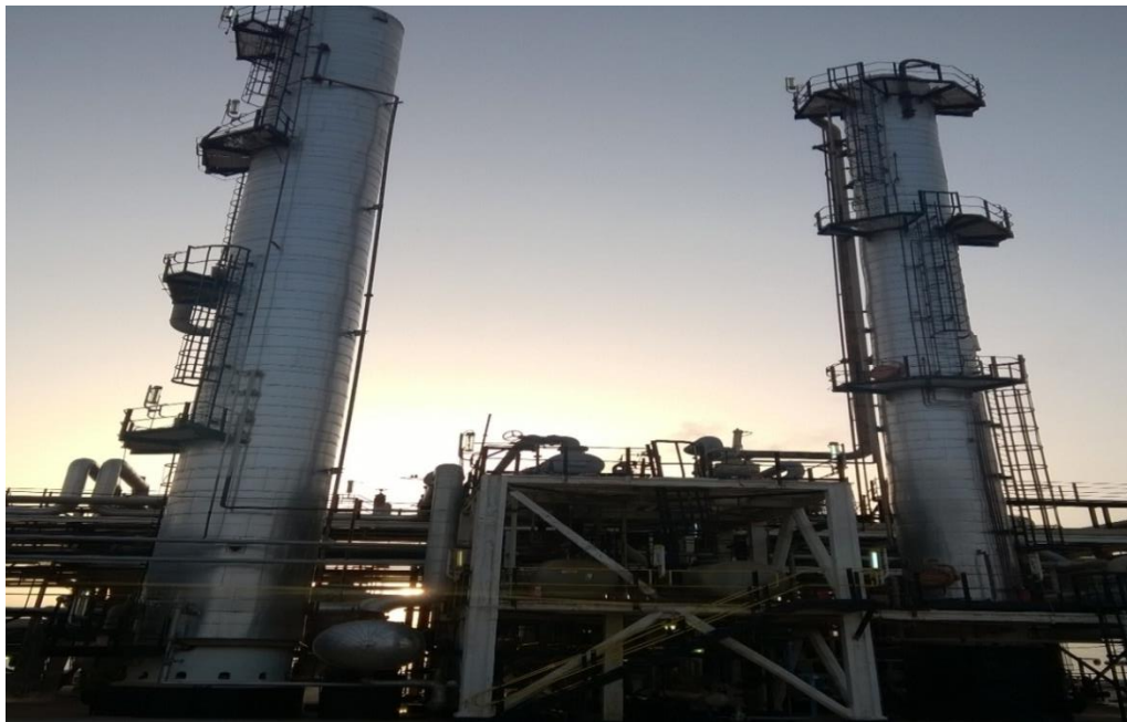
Figure II.11 : Colonnes de distillation (V601) et (V602).
