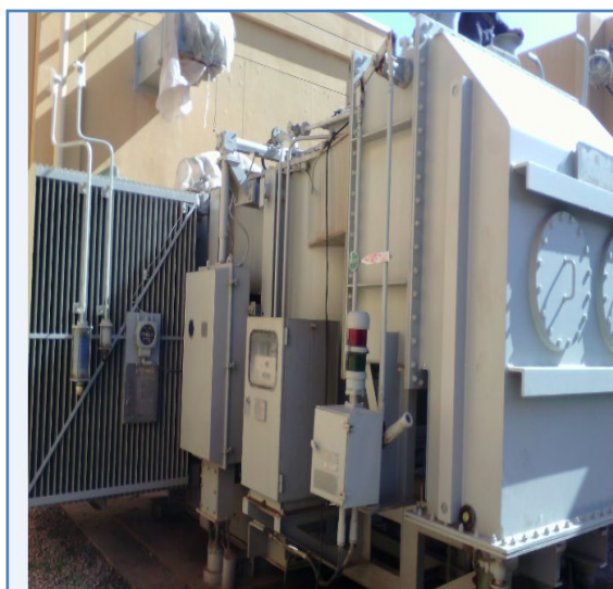
Figure 3.2 : Transformateur de puissance MT / HT
