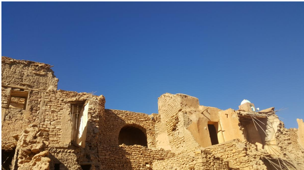
Figure31 :KasrAla'tik en dégradation
