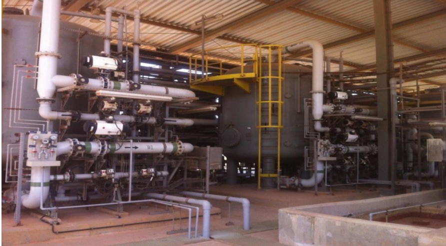
Figure I.5.L'unité de déminéralisation
