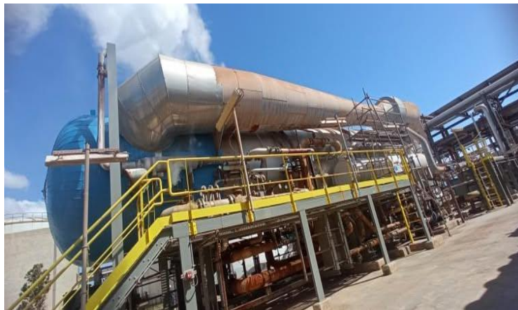
Figure I.4.L'unité de dessalement par thermo-compresseur
