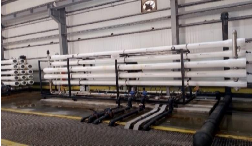
Figure I.3 . L'unité de dessalement par Osmose Inverse
