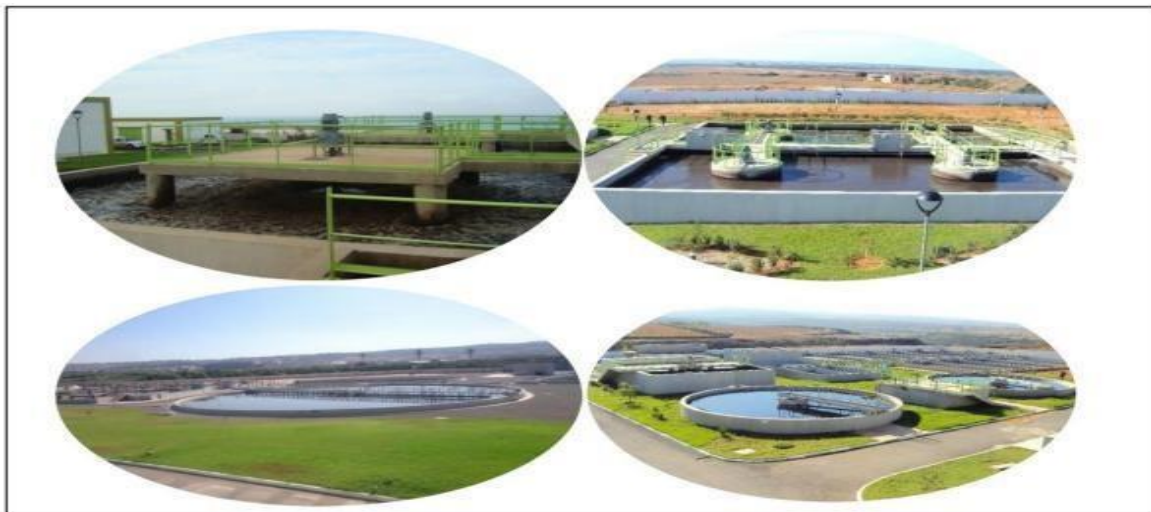
Figure II.2 : Vues sur les stations d'épuration STEP de Mostaganem.
