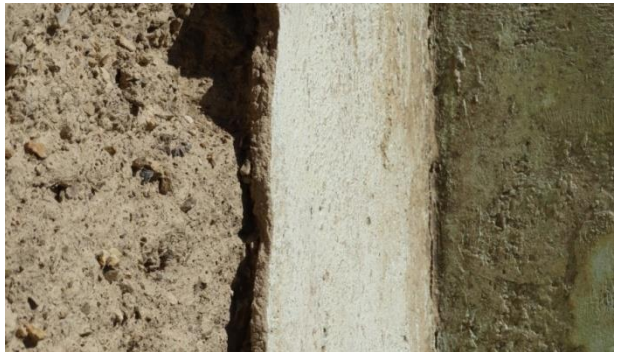
fig33-Enduit à base de ciment/sable sur mur en pisé – ciment. L'adhérence terre/ciment n'est pas
