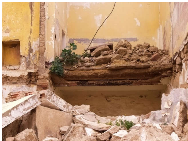
Photo 2- 57: Photo montre la dégradation des structures. Source: Auteur.
