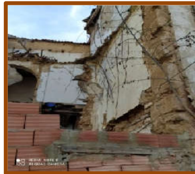
Photo 2- 21: Photo d'une construction en Etat vétuste. Source: Auteur.
