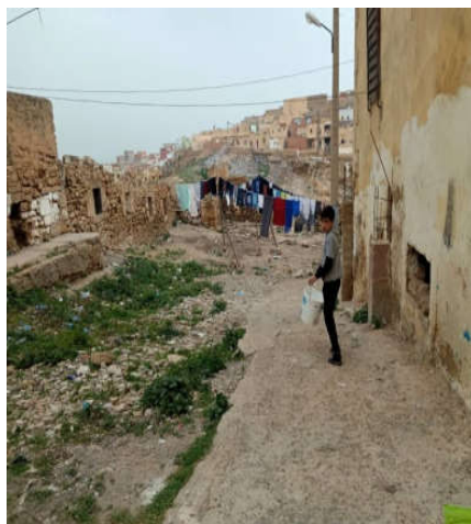
Photo 2- 49: Photo représente la squattérisations des structure dégradé et ruine. Source: Auteur.
