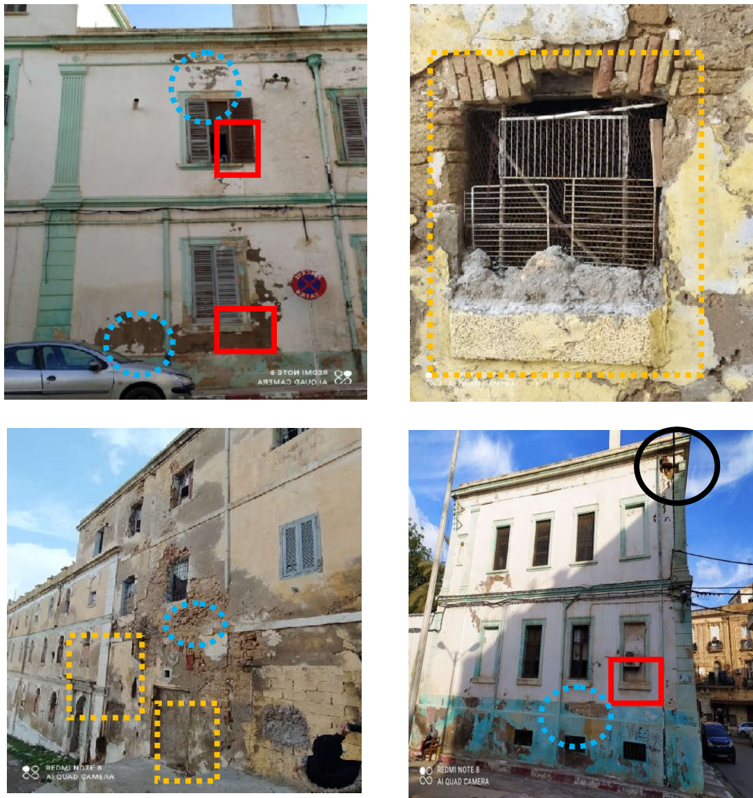
Figure 2- 67: Photo qui montre différents niveaux de dégradation des édifices.
