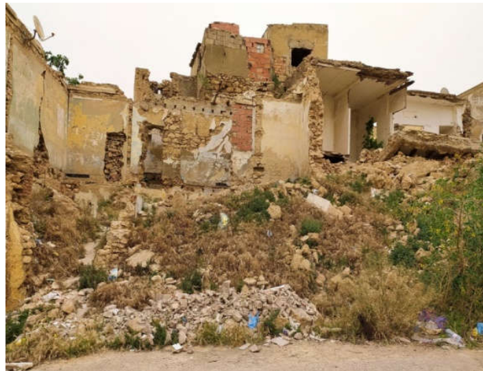
Photo 2- 60: Photo d'effondrement d'une construction due au facteur anthropique. Source: Auteur.
