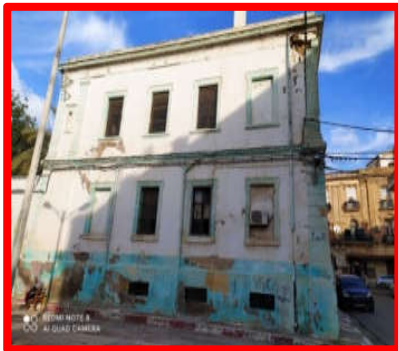
Photo 2- 22: Photo d'une construction en mauvais état. Source: Auteur.
