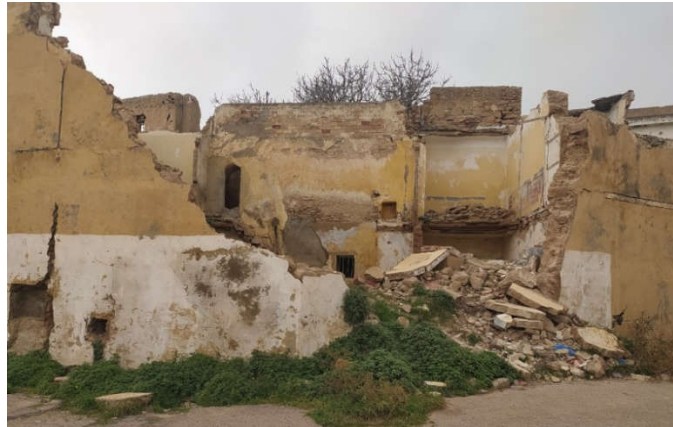
Photo 2- 59: Photo d'effondrement d'une construction due au vieillissement. Source: Auteur.
