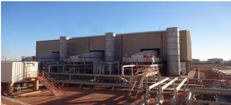
Figure II.5 : Centrale électrique du complexe gazier In-Amenas
