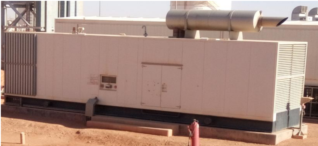
Figure II.7 : Groupe diesel CATERPILAR au niveau de CPF 400V
