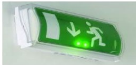
Figure 3 : Eclairage de sécurité [1].
