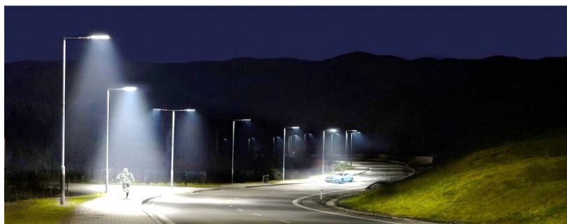
Figure 4 : Meilleur confort des usagers par l'éclairage public [9].
