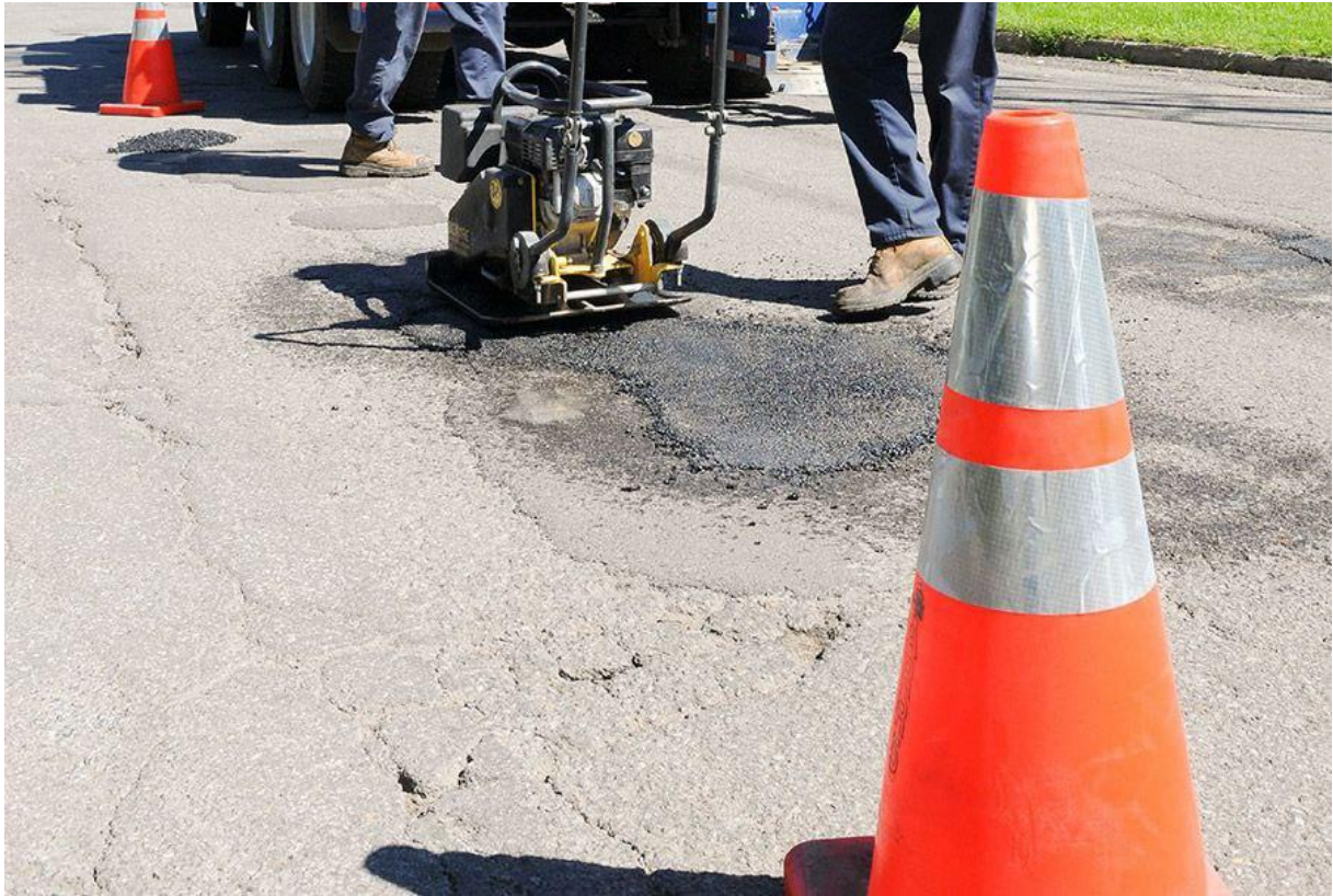
Figure III. 8: Réparations de Nid de poule
