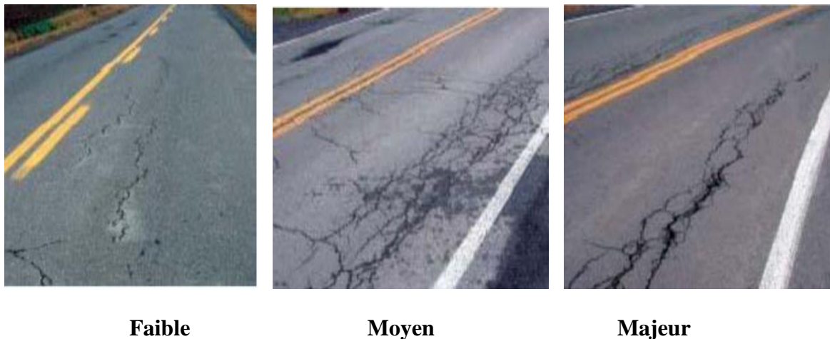
Figure I.12 : Les fissurations longitudinales
