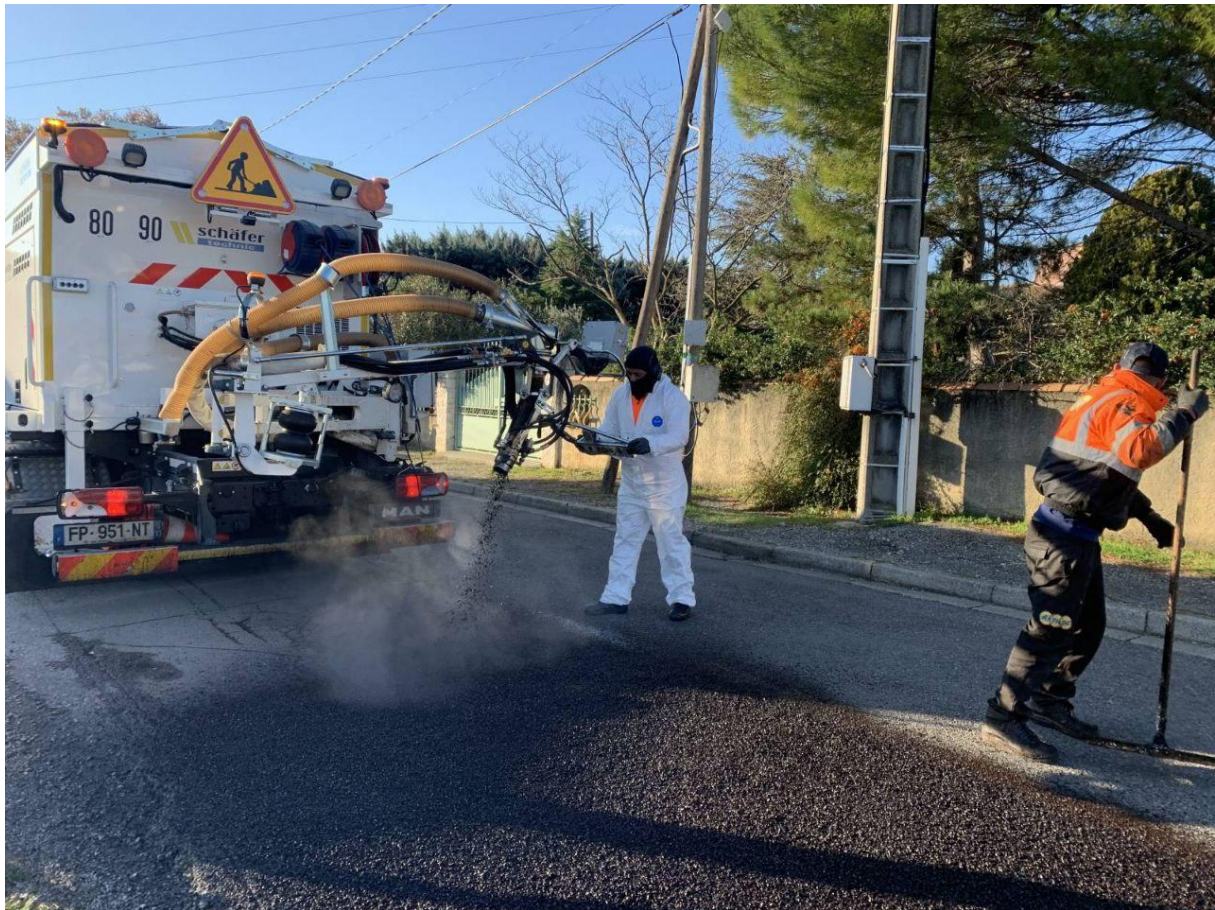
Figure III. 7: Réparations de Faïençage
