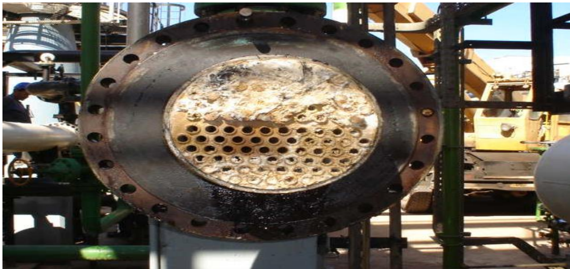
Figure III.4 : Bouchage des tubes de l'échangeur E.504.
