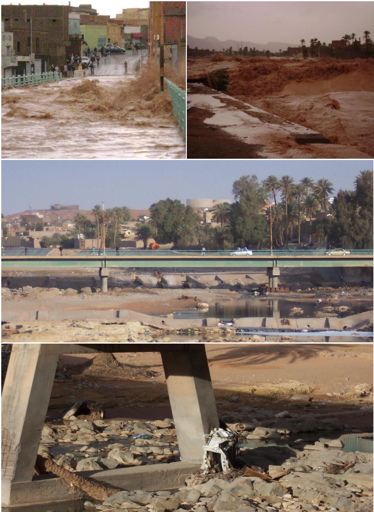
Figure 0.1: Les dégâts au niveau des ponts de la ville de Béchar, crue d'octobre 2008 (source : Halilou 2011)
