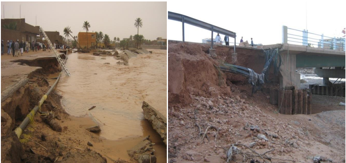
Figure 0.4: Détérioration des ponts du centre ville (source : Halilou 2011)
