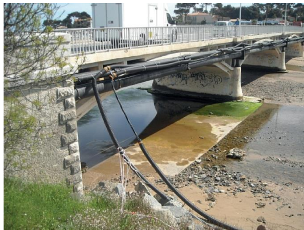
Figure 0.3: Radier béton mis à nu au droit de la travée du pont (Source : Cerema 2019)
