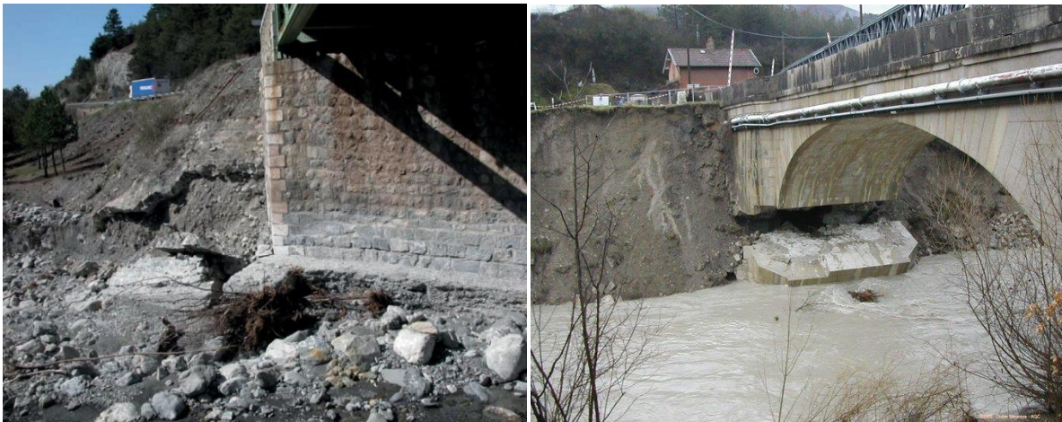
Figure 0.5: (a) Affouillement d'une culée en saillie d'un pont, (b) Effondrement d'une pile de pont par affouillement de sa fondation 18
