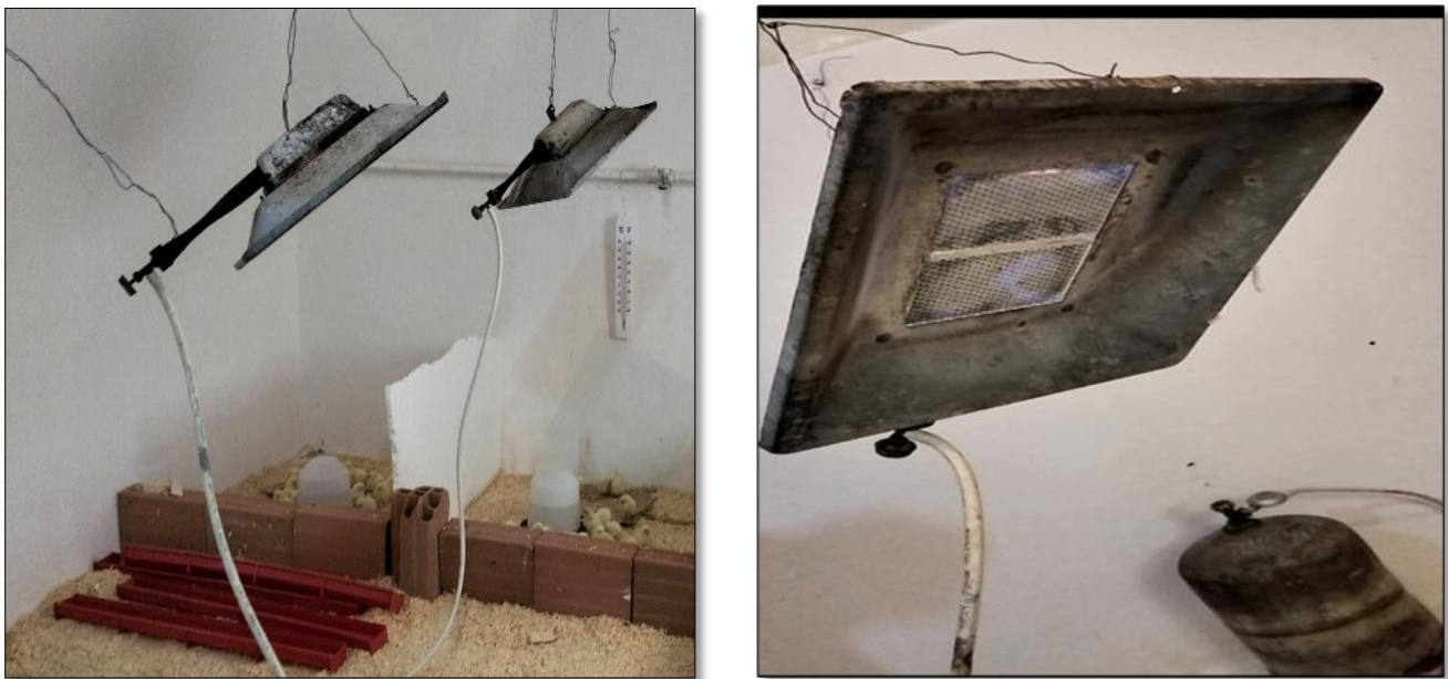
Figure 12. Système de chauffages dans le poulailler.
