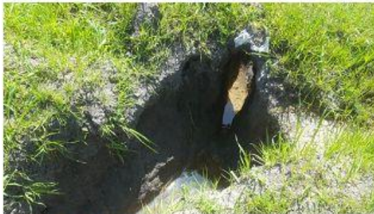
Photo 03. Érosion interne (sous terraine)
