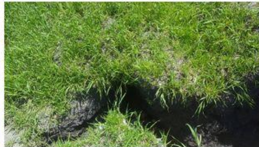
Photo 04. Érosion linéaire (Ravine)
