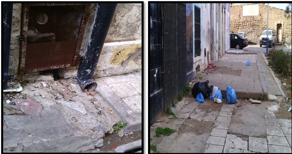
Figure 92.93 évacuation des eaux usées sur la chaussée et dépôt sauvage de déchet /auteurs 2016
