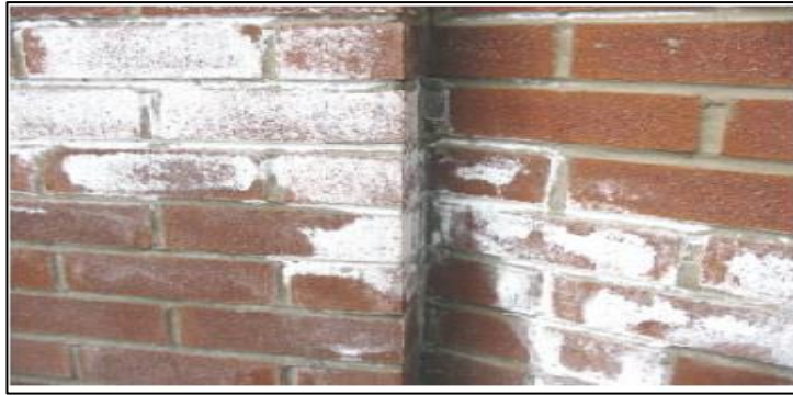
Figure (II.20) : Traces d'efflorescences de sels.
