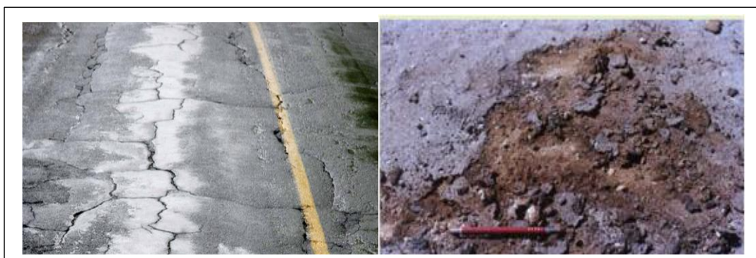
Figure (II.28): Dégradation de la route (a) trace d'efflorescences de sel (b) Couche de bitume réduite en poudre.
