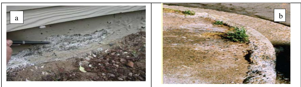
Figure (II.22): (a) Traces d'attaque physique sur le mur de fondation en béton (b) Bordure et caniveau en béton affectés par les sulfates.
