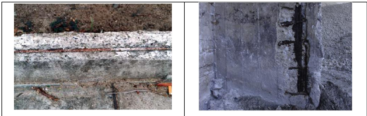
Figure (II.21): Corrosion de l'acier due aux attaques des sels
