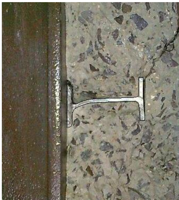
Photo 2.11 : Déformation du connecteur en « I »
