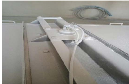
Figure III-1: injection de la graisse dans les paliers intermédiaires via une pompe à Graisse automatique [10]
