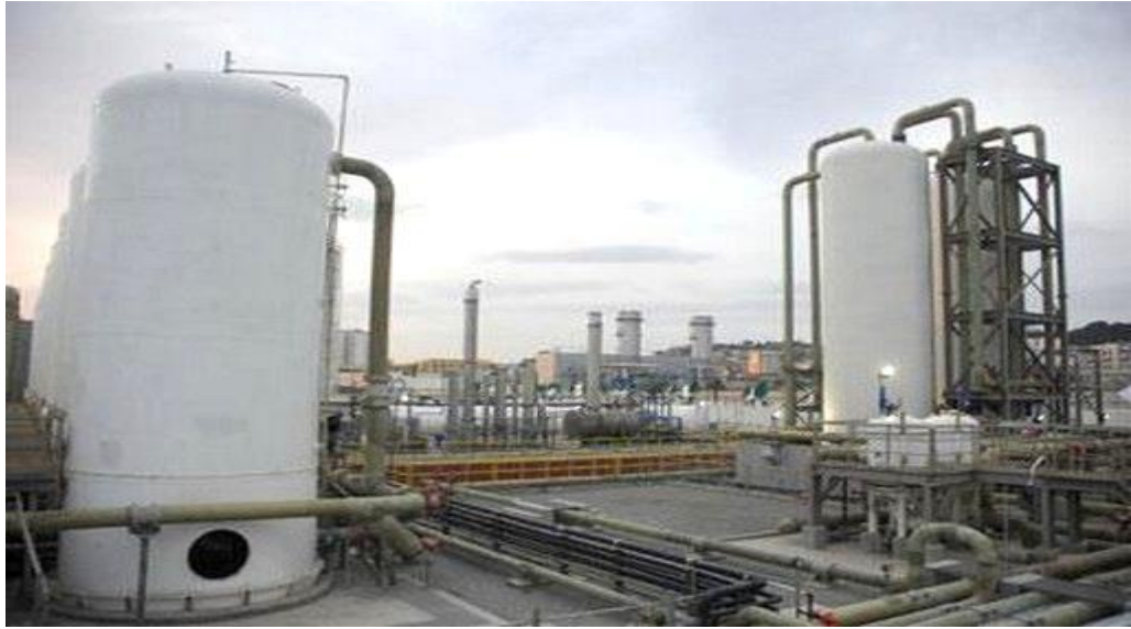
صورة للمحطة التقنية لتصفية المياه القذرة بمستغانم
