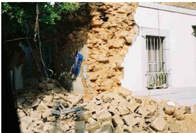
Photo 9 : les angles en maçonnerie sont très vulnérable ( DELLYS )
