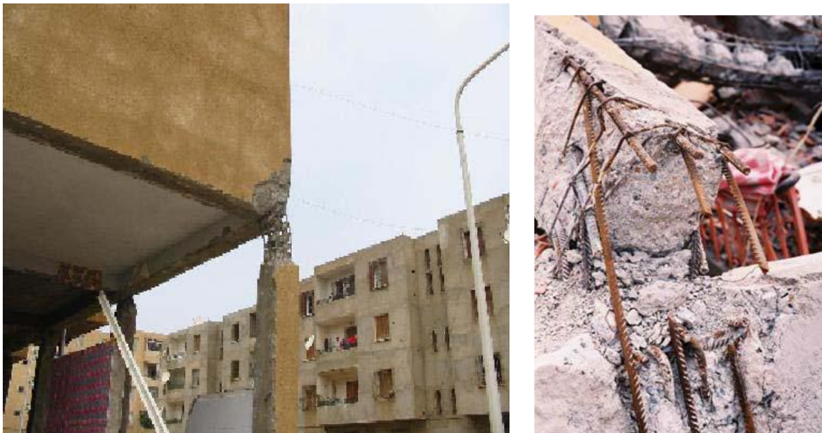
Photo 1 : plastification des nœuds en tête en pied ( BOUMERDES )
