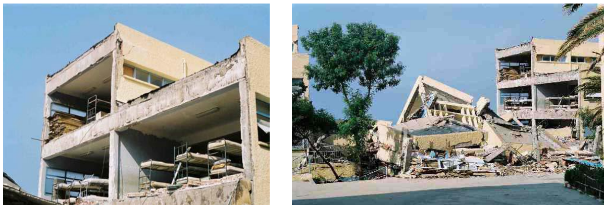
Photo 3 : poteau fort –poutre faible (DELLYS)
