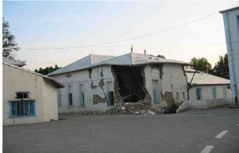
Photo 12 : l'effondrement des pignons faible (THENIA)
