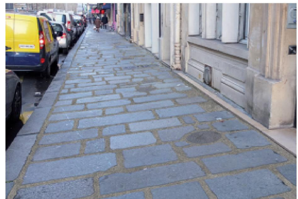
Dalles clivées à joints perméables, rue de Malte, Paris 11 e Photomontage Apur
