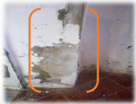
Photo 88 : l'humidité et la moisissure.
