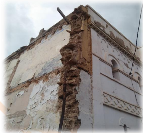
Photo 82: La destruction de la maison adjacente.
