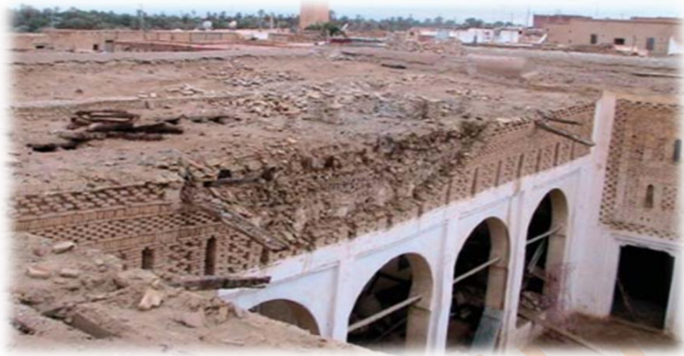
Photo 11 : Dégradation du plancher en bois 107 .
