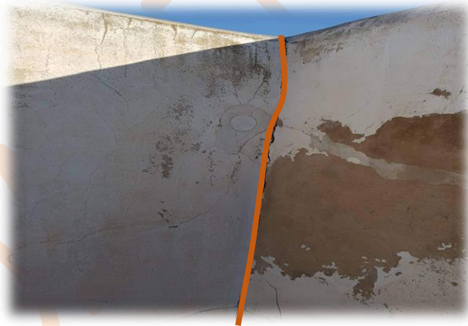
Photo 83 : Présence de mûr lézardé sur la terrasse de Dar El-Kaid (probablement descendants à l'étage inférieure).
