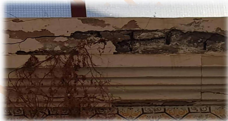
Photo 89 : la rouille de l'acier de plancher.
