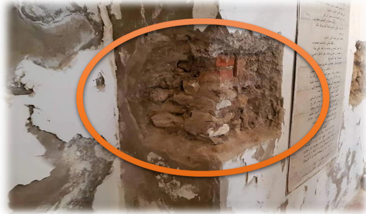
Photo 84 : L'incompatibilité des matériaux.
