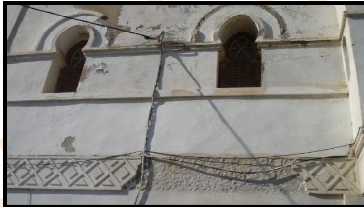
Photo 52: Installation de câbles électriques au niveau de la façade de la maison.
