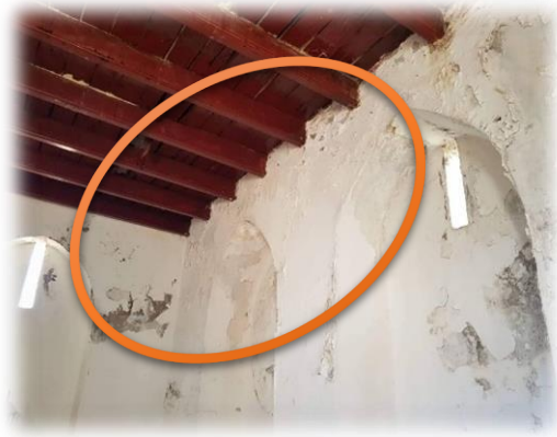
Photo 87 : la stagnation de l'eau.
