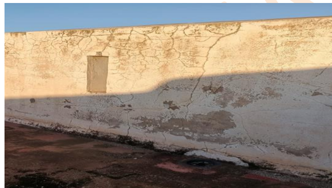
Photo 60: Faïençage des revêtements muraux.
