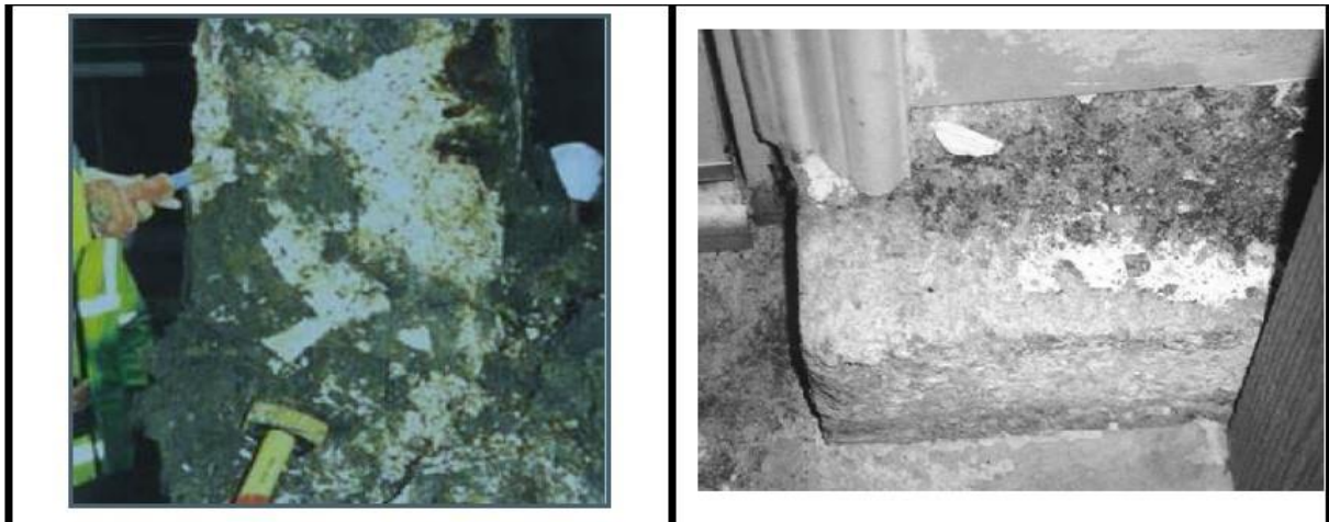
Figure 3 : Exemples des structures attaquées par les sulfates. Dommages causés par la thaumasite L'effritement et l'efflorescence
