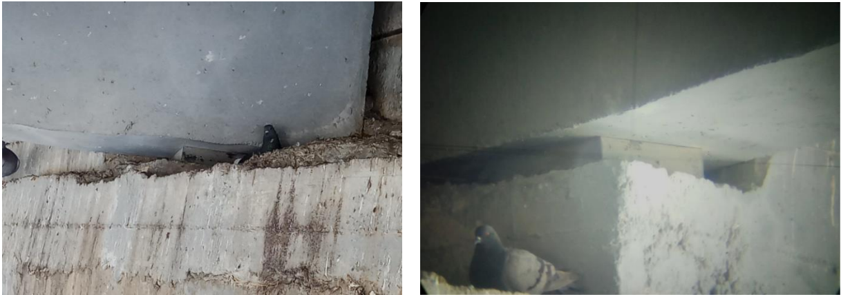
Figure 9: Vue de détail de l'accumulation des détritux des pigeons sur le sommier d'appui de la culée
