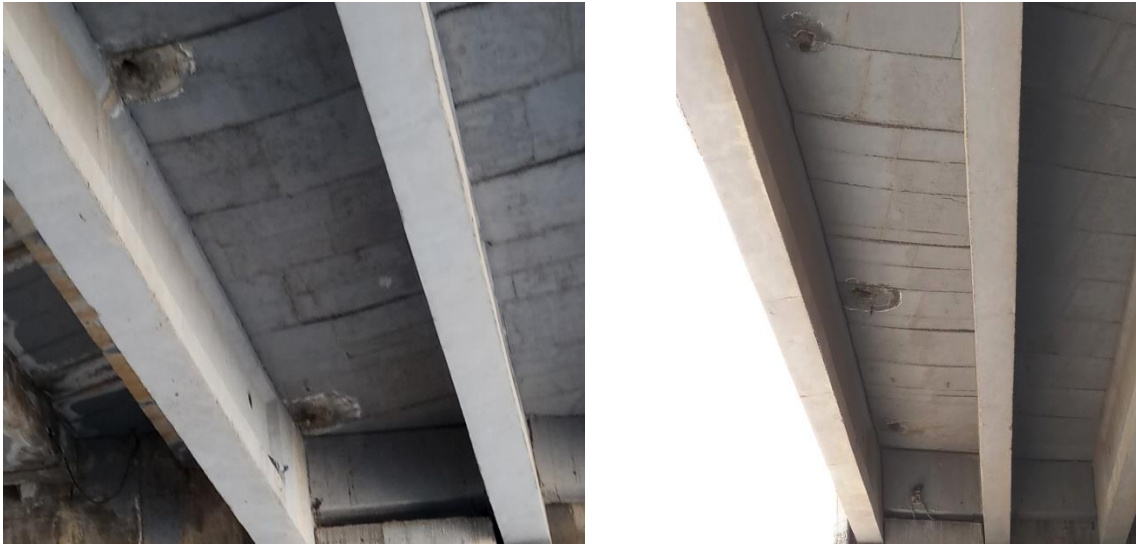
Figure 6: Vue de détail des infiltrations des eaux de pluie au droit des contours des réservations prévues pour le drainage de l'ouvrage
