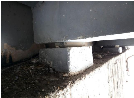
Vue de détail des appareils d'appui en élastomère fretté sous les poutres principales en travée sur culée côté Mostaganem
