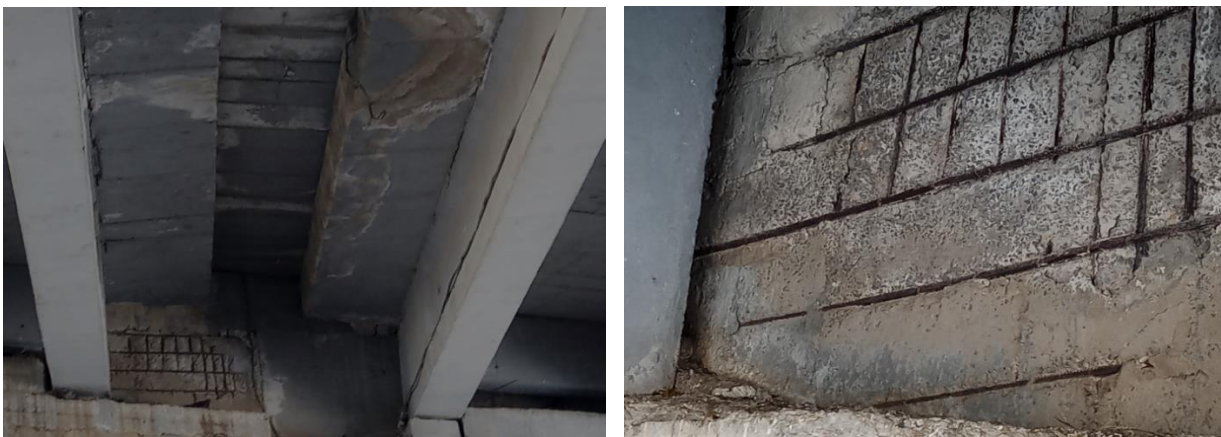
Figure 7: Vue de détail des aciers dénudés au droit du mur garde-grève à la jonction des deux tabliers transversalement
