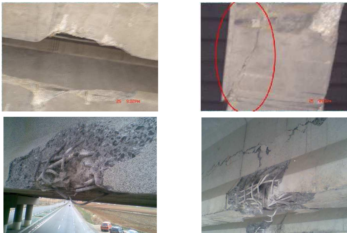
Figure 6 : Les différentes dégradations causées par le choc
