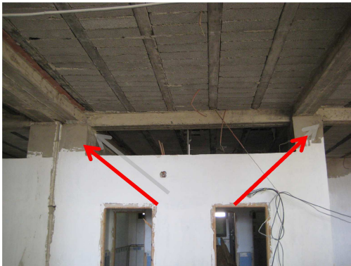
Fig.2.15 Présence de poteaux courts
