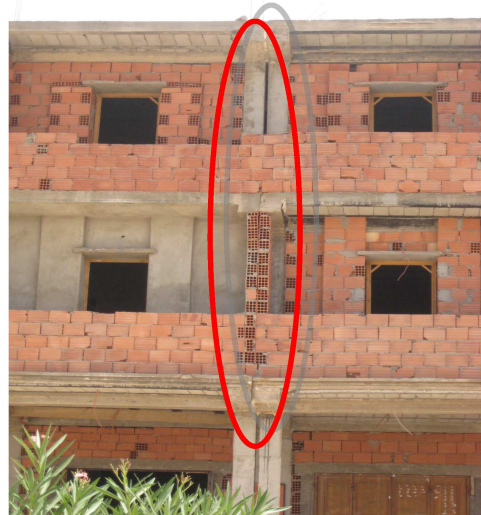
Fig2.16 Mauvaise conception et exécution du joint
