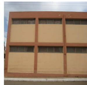
Présence d'effet du poteau court
