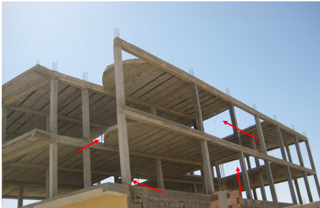
Fig.2.10 Affaiblissement du diaphragme par la présence des baies sur le plancher
