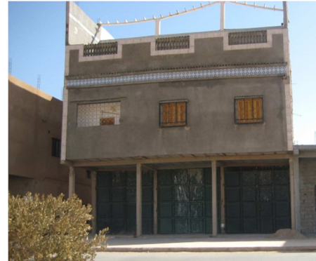
Faiblesse de la structure en RDC
