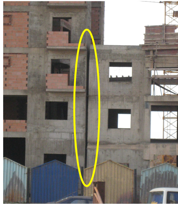
Fig. 2.18 Exécution soignée d'un joint parasismique
