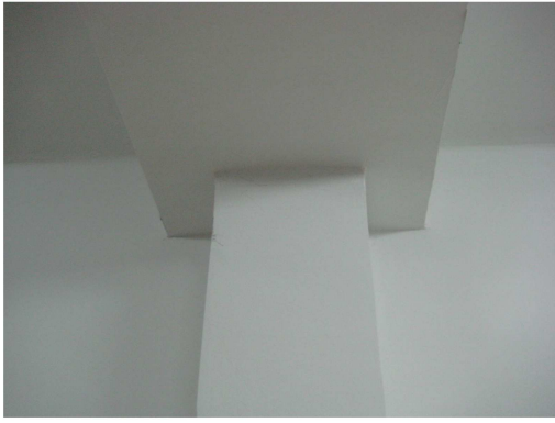
Fig.2. 13 Non-respect du principe poteau fort- poutre faible
