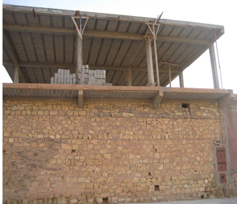
Fig.2.11 Hétérogénéité structurale (Mur porteur en RDC – Poteaux et poutres en étage)
